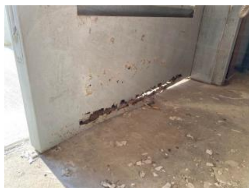
Rusted metal door
